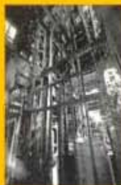
VUE DES INSTALLATIONS ENCIPI. SALLE DES PENSUS. PHOTO C.D.T. / J.C. KAHN.
