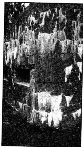
Het fort is opgetrokken van ongewapend beton. Door de zure regen lost de kalk in het beton op en vormt prachtige patronen op de grauwe muren.
